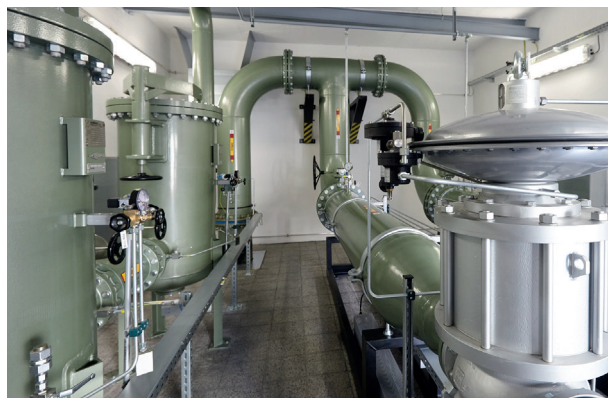
Blick ins Innere einer Gasdruckregelanlage | Fotos: Swen Gottschall
